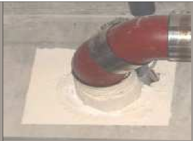
B Mit Brandschutzcoating beschichtete Isolierung
