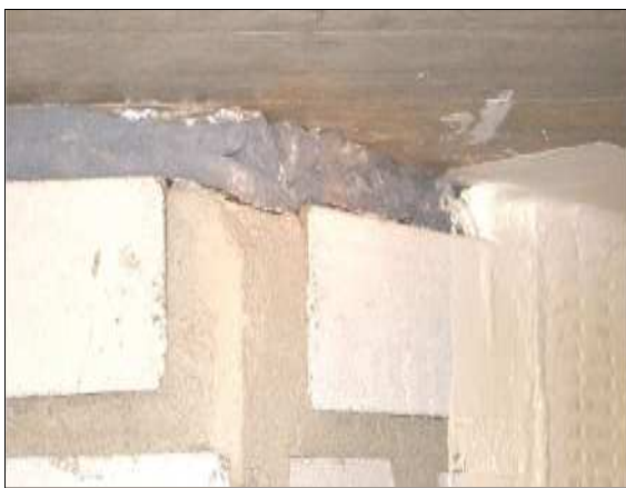
C Unbeschichtete asbesthaltige Isolierung zwischen Kalksandstein und Betondecke
